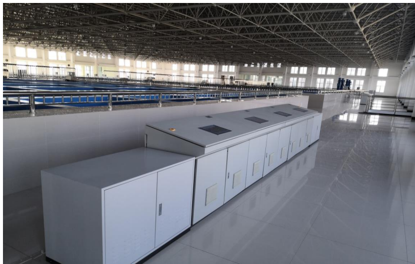
絮凝沉淀池 PLC 现场子站
